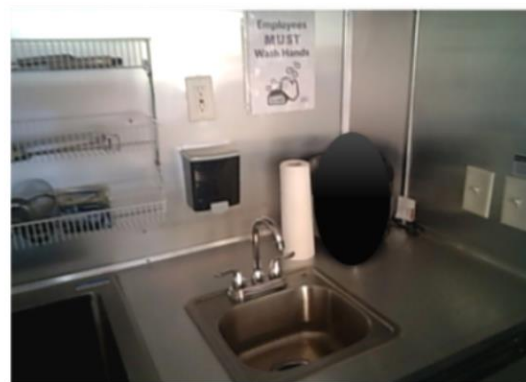
Fregadero para lavarse las manos
