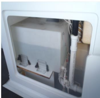
Tanque de agua potable
